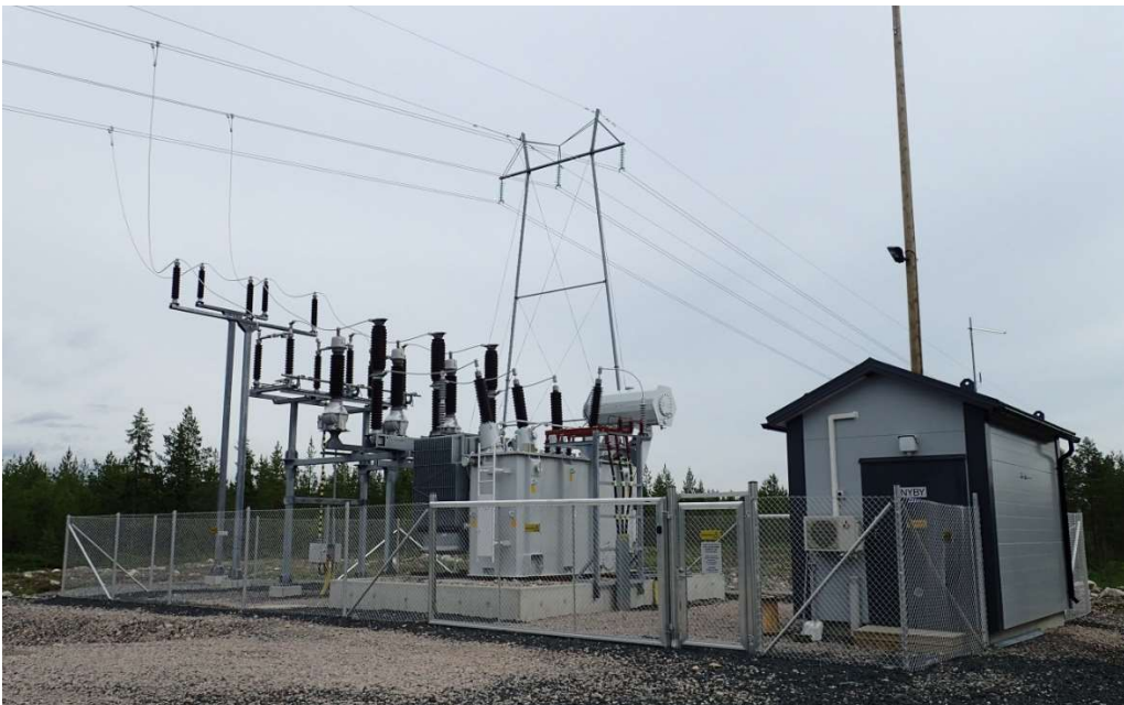
Kuva 16. Esimerkki tuulivoimahankkeen sähköasemasta.
